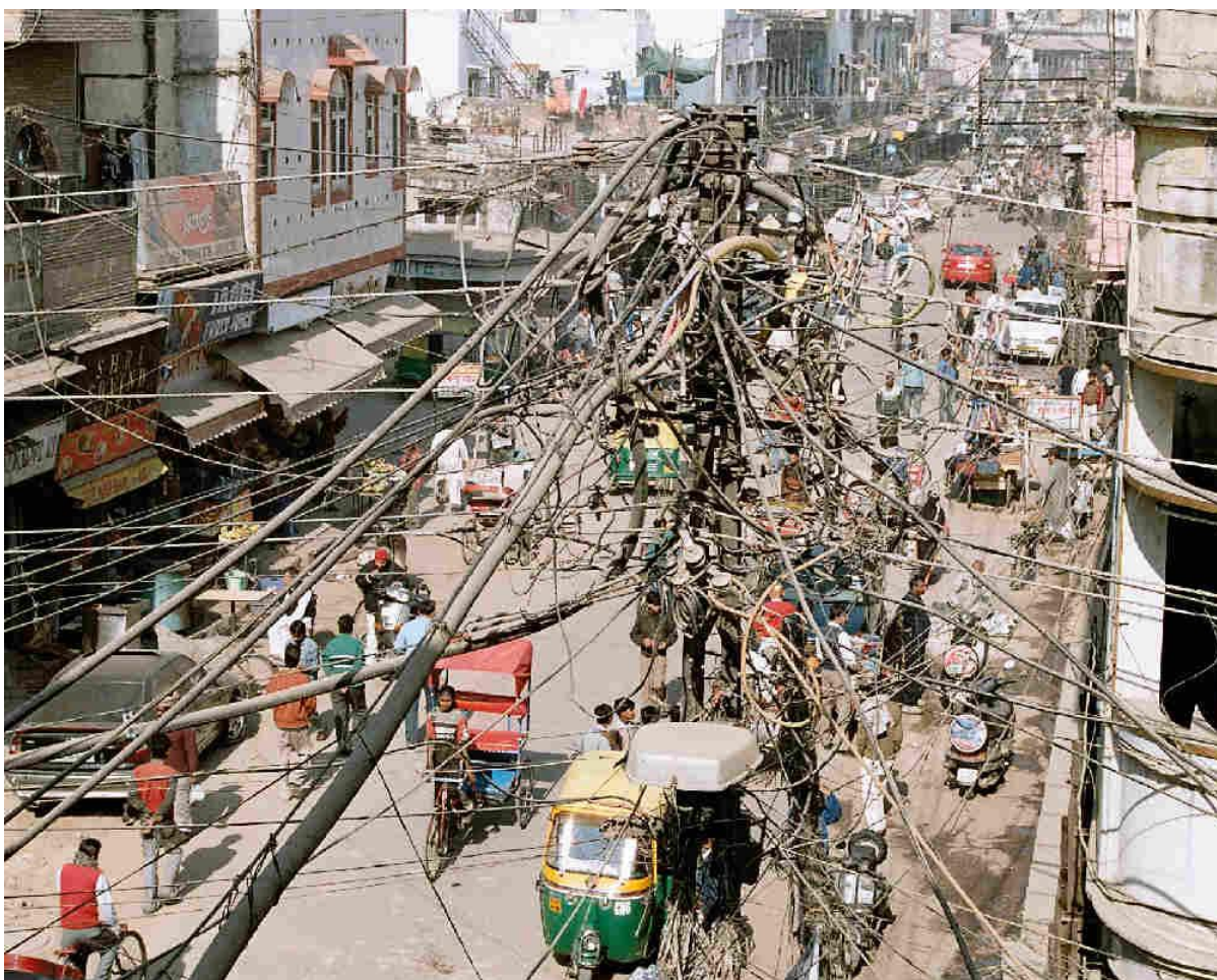
Instalacja elektryczna, Delhi. Fot. Krzysztof Łoziński
